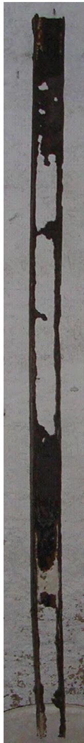
Abb. 1. Korrodierter Träger, dessen Entdeckung die Restaurierungsarbeiten ausgelöst hat.
